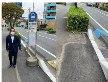
榎引町2丁目の「計量検定所前停留所歩道改修工事」が完了し、安全にバスを待つことができるスペースができました。
